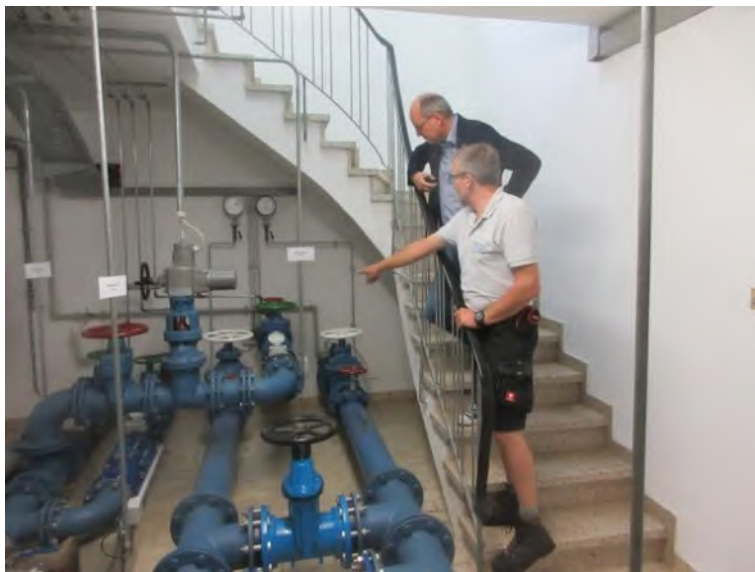
1. Bürgermeister Achim Höfling und sein Wasserwart Michael Schaupp im Wasserwerk in Hundsbach
