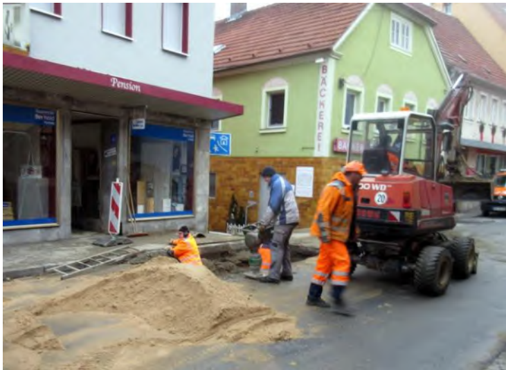
Rohrbrüche gab es am laufenden Band seit den sechziger Jahren
