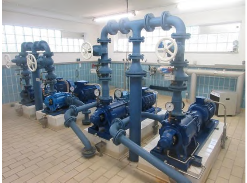
Das Rohrnetz im Inneren eines Wasserwerks wie hier in Hundsbach
