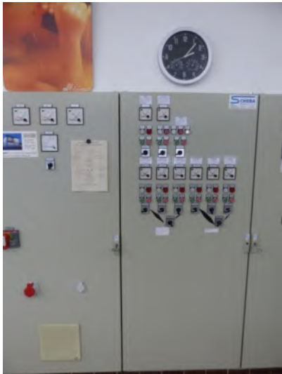
Heute verfügen die Wasserwerke über einen elektrischen Steuerungsschrank, wie hier bei der Kaistener Gruppe
