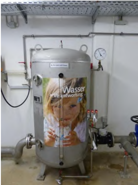
Auch ein Druckbehälter wie hier in Kaisten ist ein normales Ausstattungsstück für ein Wasserwerk
