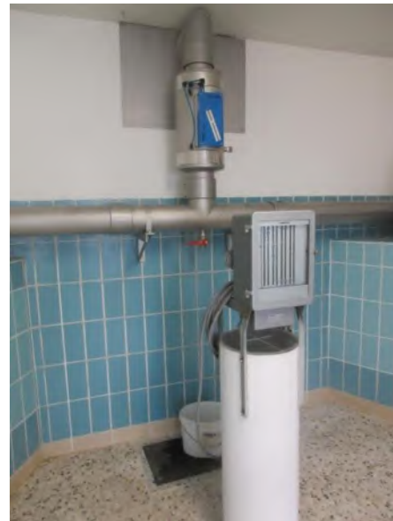
Ein Foto aus dem Hundsbacher Wasserwerk
