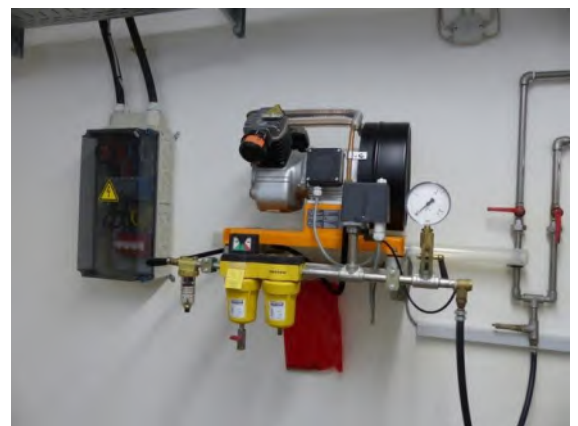
Kompressor im Wasserwerk
