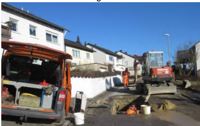
Immer wieder machten Wasserrohrbrüche den Stadtarbeitern zu schaffen, wie hier in der Sudetenstraße
