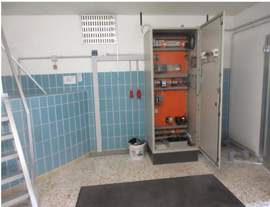
Anlage in Hundsbach
