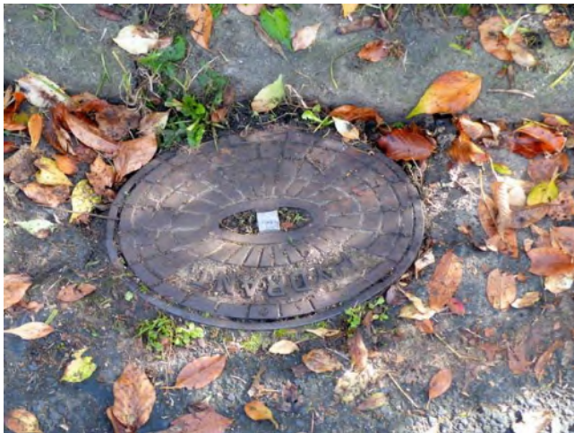
Unterflurhydrant in der Günthergasse
