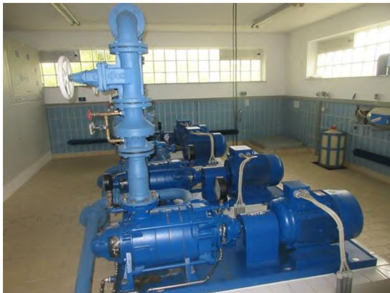
Das Innere des Wasserwerkes in Hundsbach
